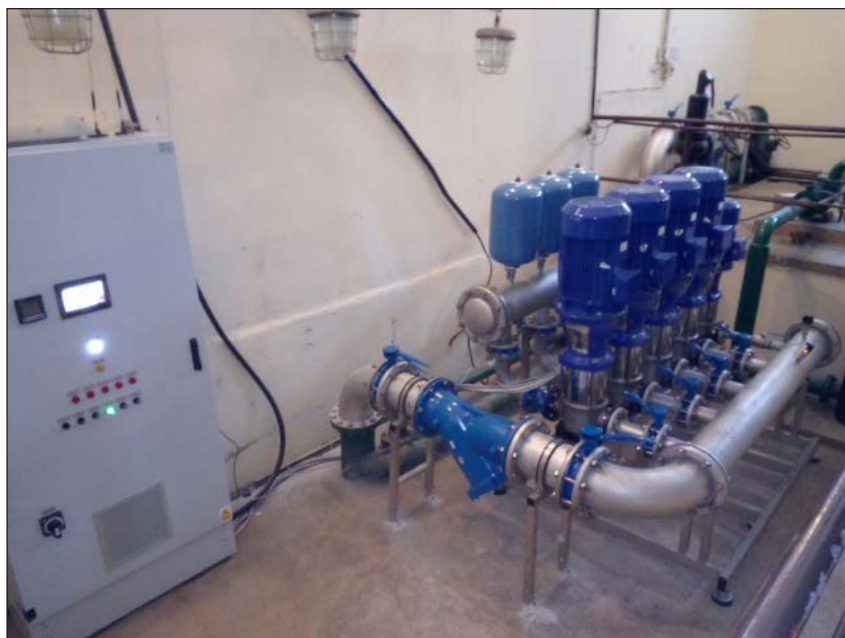
Modernizacja Stacji Uzdatniania Wody – pompy falujące.
