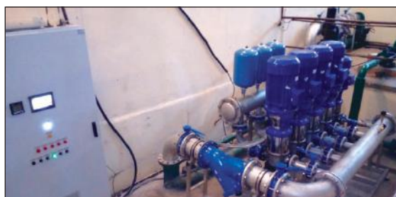
„Pompy falujące” Stacji Uzdatniania Wody
